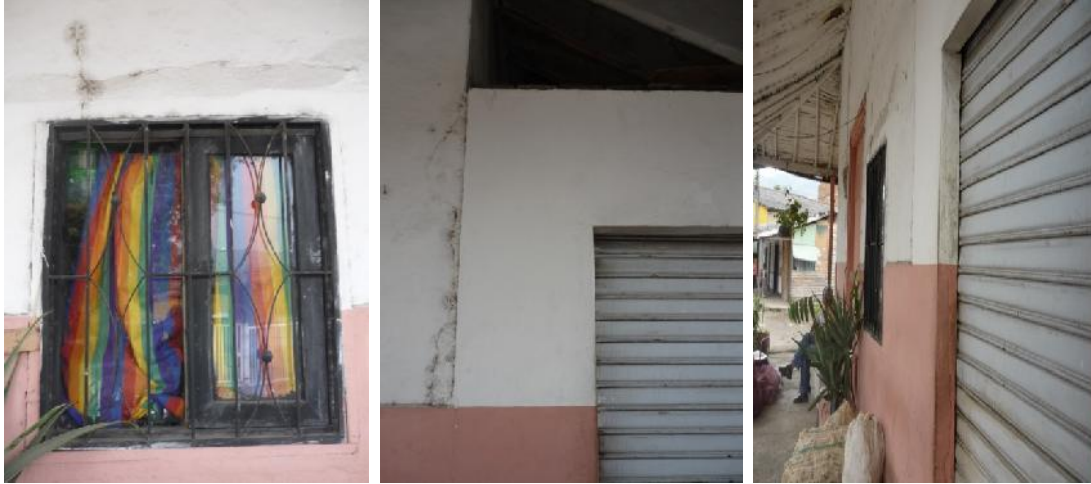
La ventana no existía y ese muro es un añadido bajo el alero. No había rejas ni ventanas de hierro... 2011
