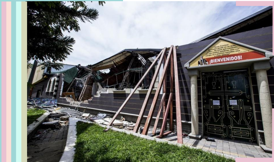
Figura 5 Colapso techo iglesia Pío X, Municipio de Itagüí. Medellín 2018.
