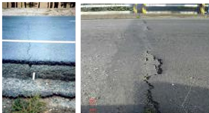
Figura 18. Fisura por reflexión de juntas
