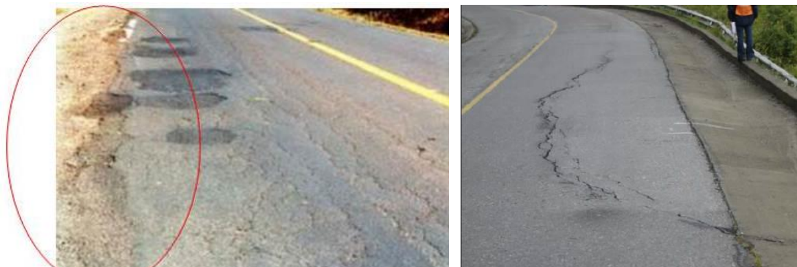
Figura 14. Fisuras y Grietas en Media Luna
