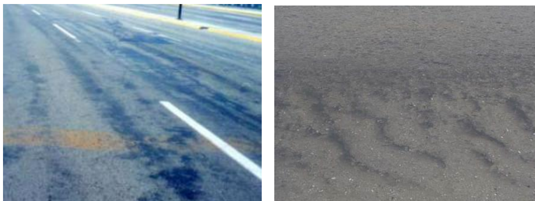
Figura 11. Exudación de Asfalto
