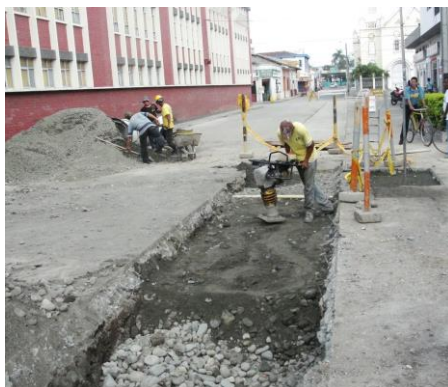
Figura 20. Brechas de servicios públicos
