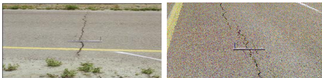
Figura 12. Fisuras y Grietas
