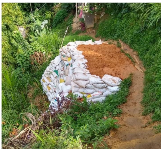
Figura 18. Lleno inadecuado en ladera cerca a la Quebrada Los Gómez.
