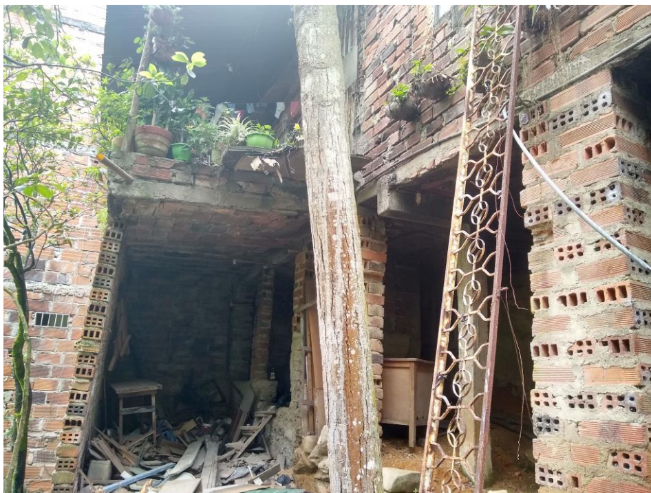
Fig. 9. Elementos estructurales no avalados por la NSR-10 (columnas)
