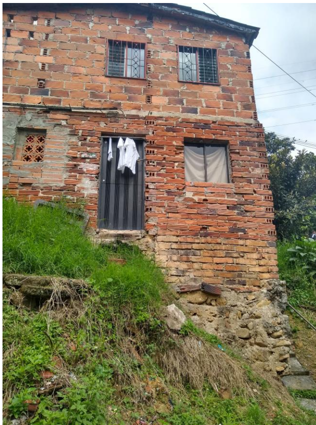
Fig. 8. Cimentaciones consideradas como peligrosas y superficies de difícil acceso
