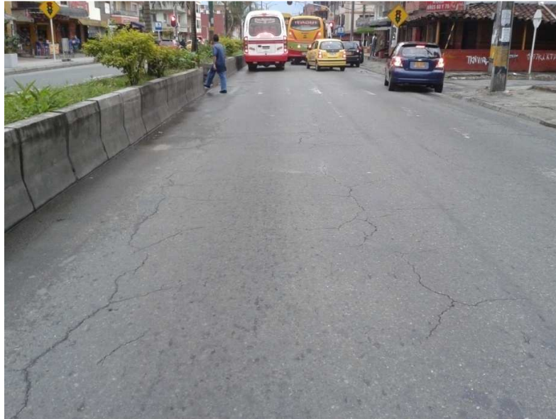
Foto 17: Fisuras transversales en la carrera 52 con calle 80 Costado oriental. Vía objeto de estudio.
