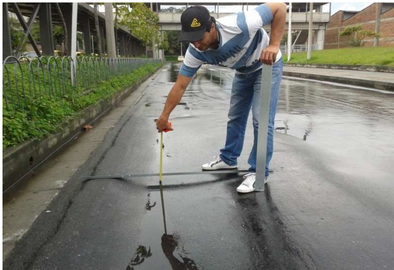
Foto 1: Ahuellamiento del pavimento calzada oriental Sector Estación del Metro Itagüí.
