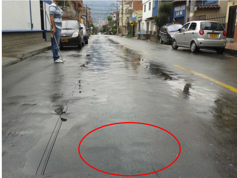
Foto 9: Exudación de asfalto sobre el pavimento. Calle 46 con carrera 49
