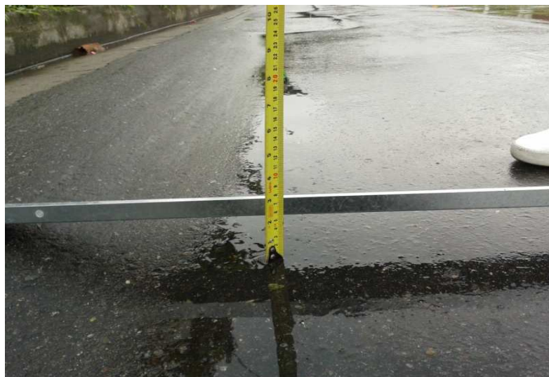
Foto 2: Detalle de la deformación del pavimento de 5 cm, calzada oriental Sector Estación del Metro Itagüí.
