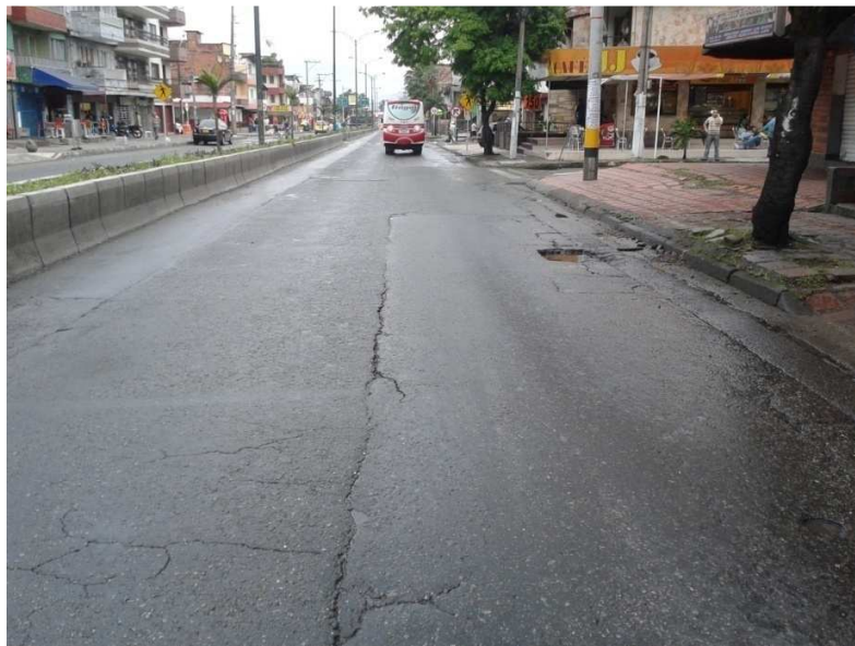
Foto 18: Bache en la carrera 52 con calle 80 Costado oriental. Vía objeto de estudio.
