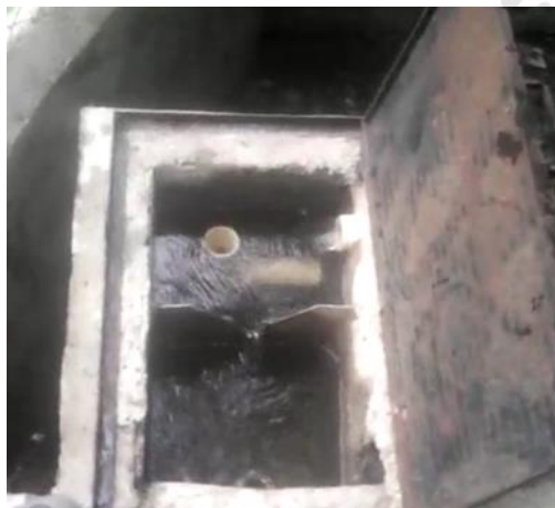
Figura 20: Estructura de control del sistema de captación por el método de bombeo. Fuente: [Obtención propia].
